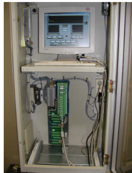
Bild 4: fest installierte Messanordnung im PSW Geesthacht
